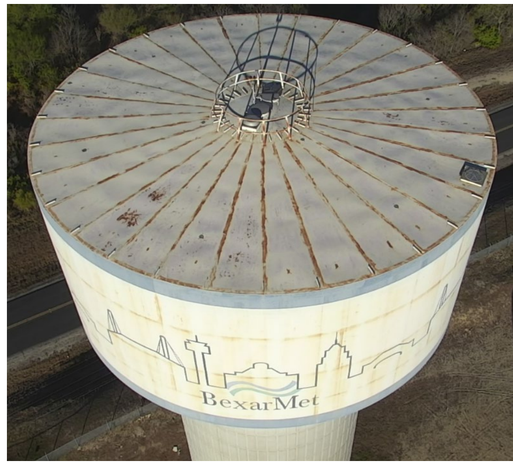
Existing 1.0 MG EST
